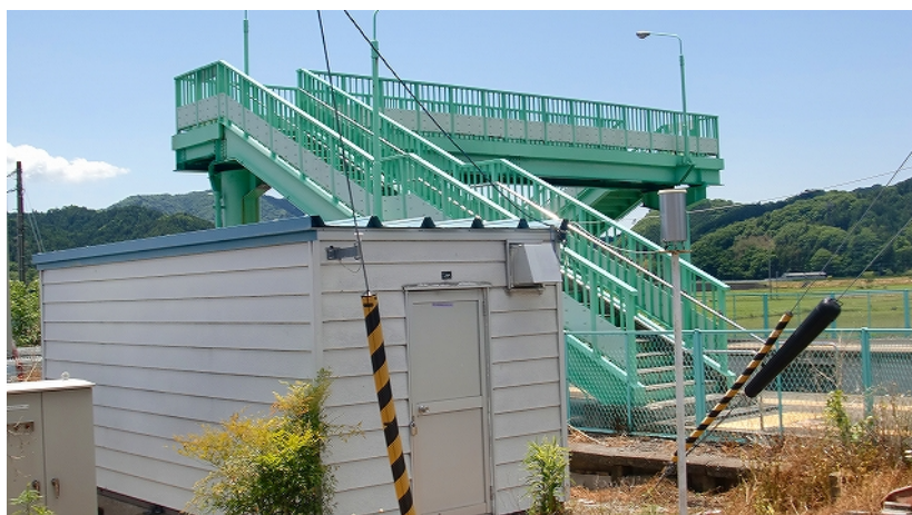
J R軌道制御設備室
